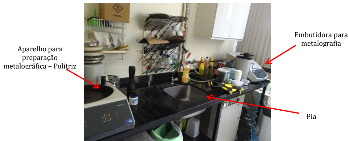
Figura 12 - Pia e equipamentos com ligações irregulares na drenagem no LMC
