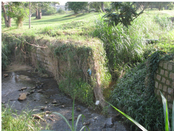
Figura 1. Local de confluência ao rio do Meio próximo à editora da UFSC; a montante deste local ocorreu grande desmoronamento dos taludes em julho de 2015.
