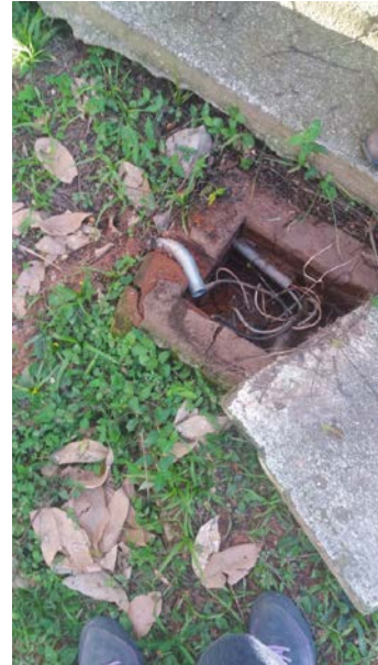
Figura 11. Fonte de energia para o sistema no P1 (Exutório)
