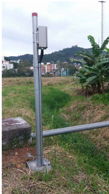
Figura 16. Poste e Caixa Ambiental no ponto P4
