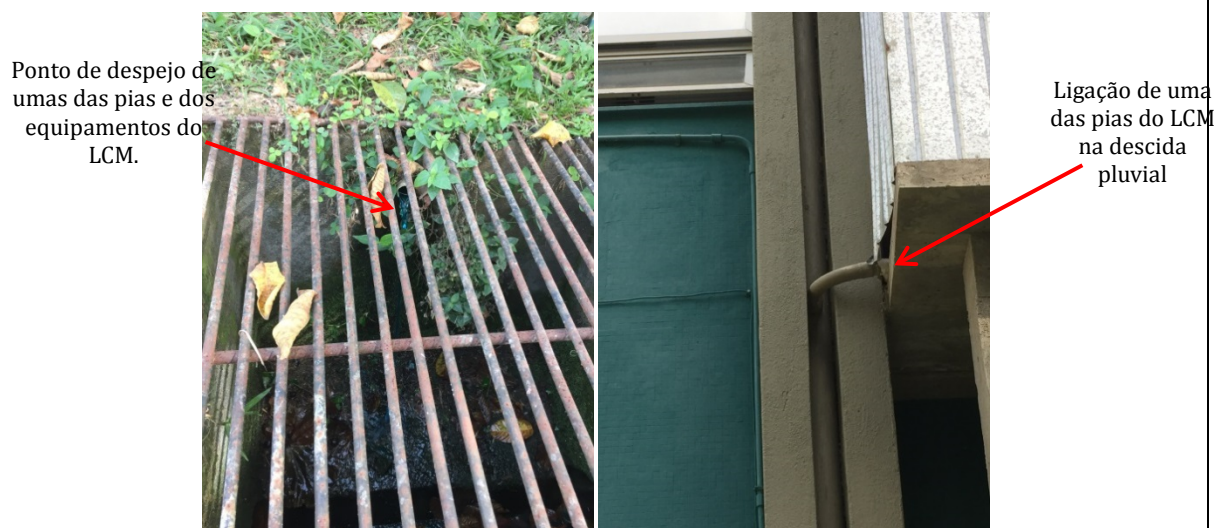
Figura 11 - Despejo de efluente do LCM na caixa de passagem da rede pluvial (esq.) e ligação irregular da pia do laboratório na descida pluvial do prédio (dir.).
